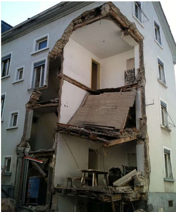
Fröhlichstraße, Zürich (Hauseinsturz, 2011)
